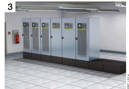
Après 30 minutes : 800 kW, mode on-line double conversion
